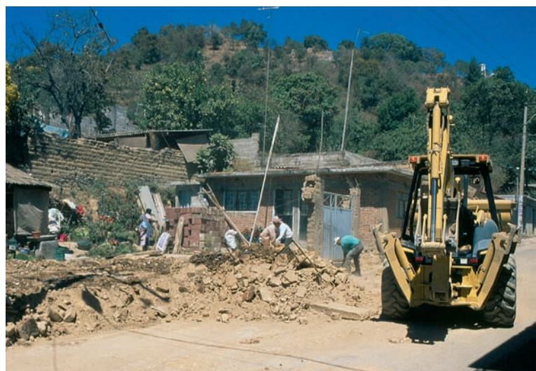
Destrucción de una vivienda de adobe en Alpanocan, Pue
