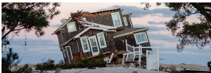
Mantoloking, N.J., 5 de noviembre de 2012 - Esta residencia fue destruida por la devastadora marejada ciclónica del Huracán Sandy. Foto de FEMA
